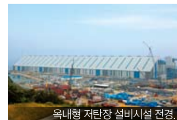
육내형 저탄장 설비시설 전경.
