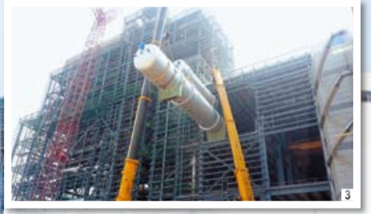
1 약 92%의 공정률을 보이고 있는 당진화력발전소 9·10호기 기전공사 현장 전경. 2 보일러 미탄기 설치 모습. 3 자재 리프팅 모습.
